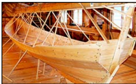
"Hjelmkonå" under bygging på Husa-notra i Valsøyfjord. Kyrkjebåten er vel 10 meter lang og har plass til 14 roarar. Midlane er skaffa ved gaver og dugnad.
